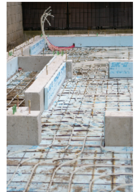
蓄熱用の温水パイプを敷き並べた状態。土間スペースと他では配管のピッチを変えている。
